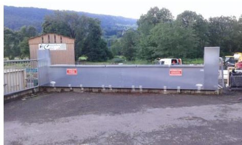
Équipement anti chute de tous les quais
